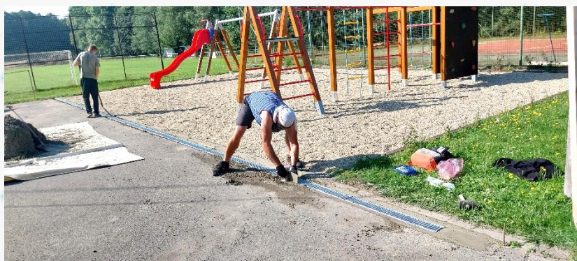
Odvodnění dětského hřiště ve fotbalovém areálu.
